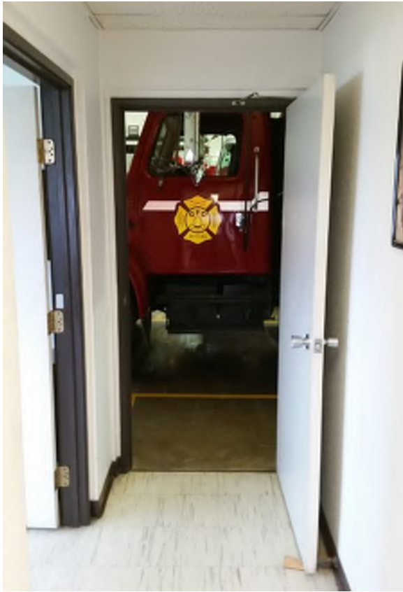
Door knobs not ADA accessible
