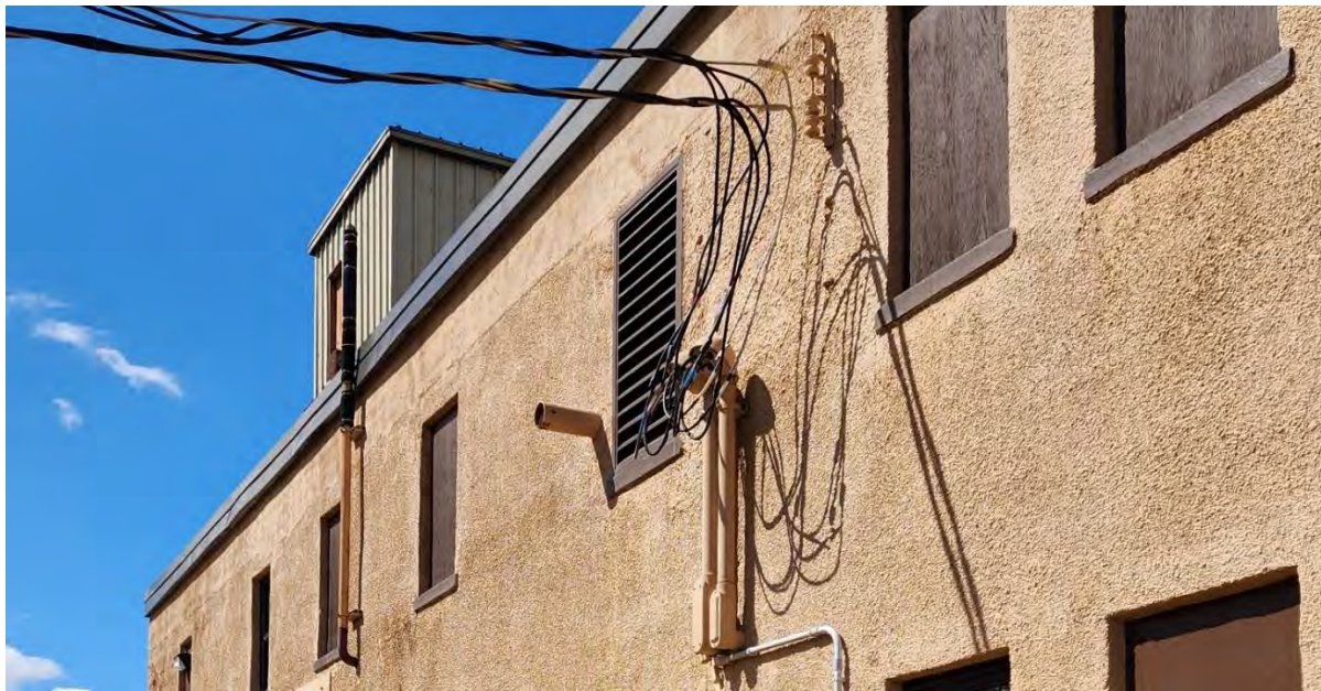
Exterior electrical. (Photo: 20240411_150252)
